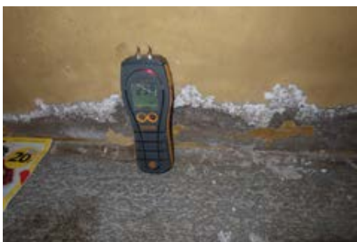
Saltutslag på grunnmur.
