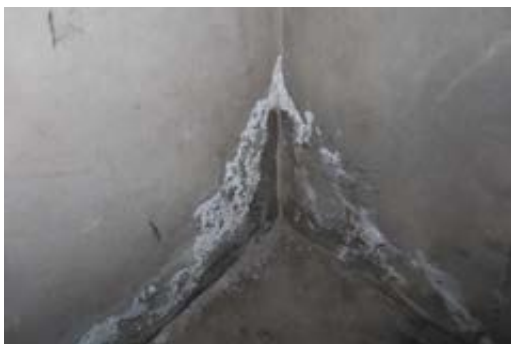
Saltutslag på grunnmur.
