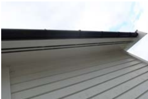
Luftespalte i kassakledning.
