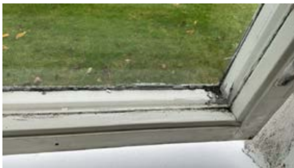
Koblet uisolert vindu vaskerom.
