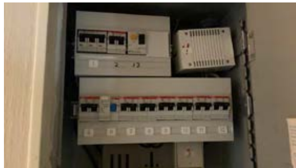
El-skap med automatsikringer
