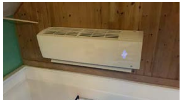
Varmepumpe i trappeoppgang.
