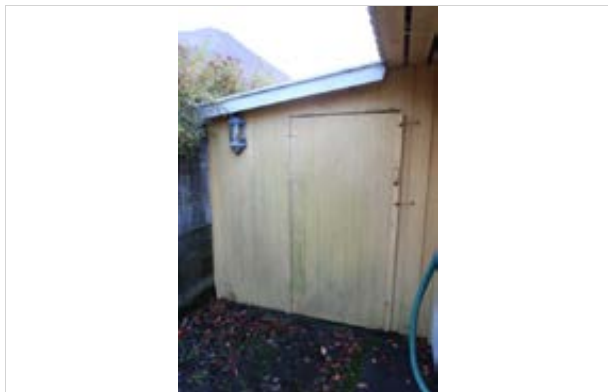
Slitt vegg med noe råteskade.
