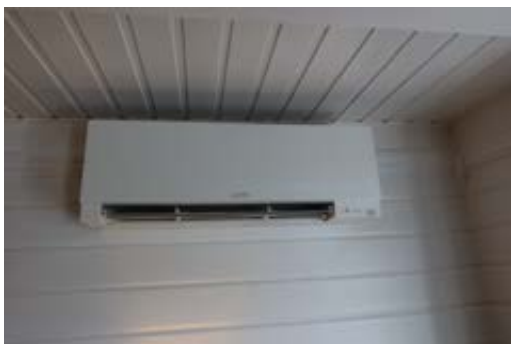
Varmepumpe i stuen.
