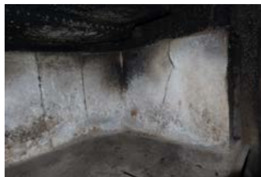
Sprekk i ildfast stein på vedovn 1. etasje.
