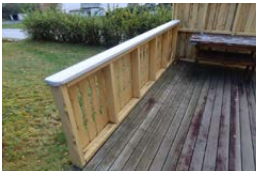
Trekkverket må festes bedre.
