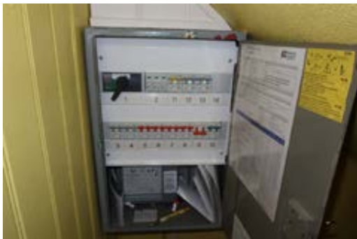
El-skap med automatsikringer
