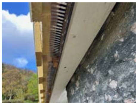
Bra lufting, og musesperre på nordvegg
