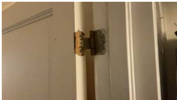
Skade på dørhengsle til dør kjøkken.
