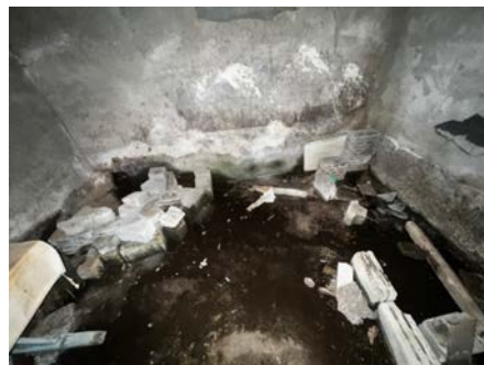
Deler av område med sulfatskader.
