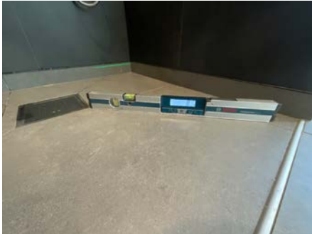
Avvik på lokalfall i dusjen.
