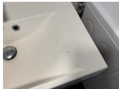
Avskalling i servant.
