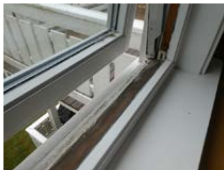
Slitt karm på de eldste vinduene
