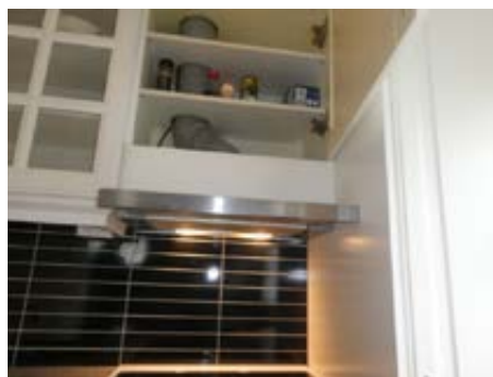
Uttrekk ventilator tar borti sideliggende skap
