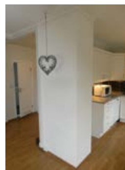
Pusset og malt pipe i leiligheten
