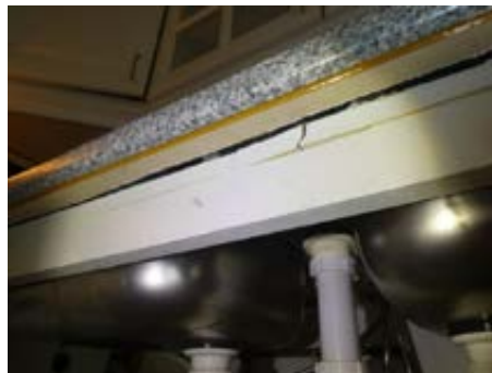
Liten skade på skrog under oppvaskkum
