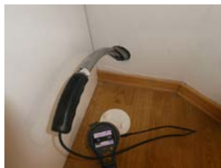
Fuktmåling i vegg
