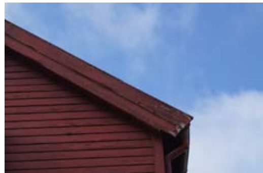
Vindskier har værslitasje/aldertegn
