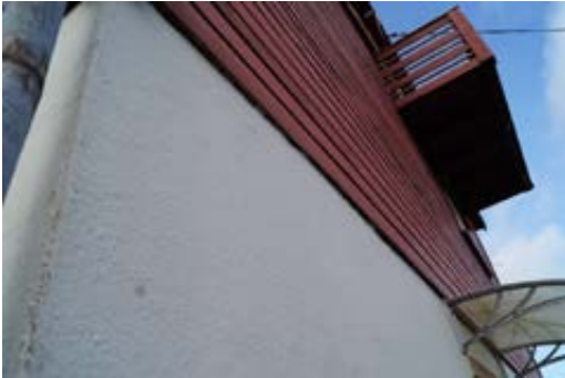
Det er ingen eller liten lufting i nedre kant av kledning mot grunnmur.
