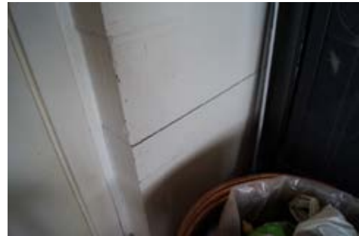
Sprekk i brannmur på stue
