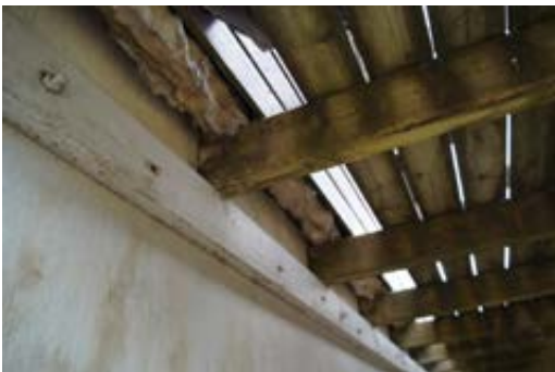
Etterisolert yttervegg (vest) – feil utført Ufagmessig avslutning nederst. Utett konstruksjon. Her er det:
