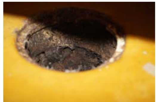
Eldre sluk. Støpjernsluk i gulv er rustet i overflatene.
