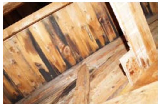
Taket har hatt lekkasjeprosblemer tidligere, har svakheter som kan gi nye problemer.
