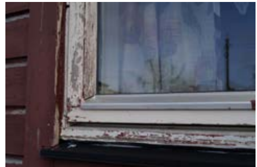
Overflate slitasje utvendig karm / omramning
