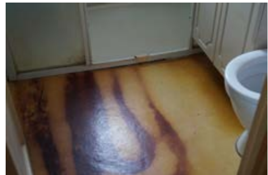
Misfarget overflate og porøst belegg, dels løst fra underlag. Badet bør i praksis regnes som et rehabiliteringsprosjekt.
