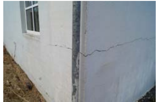
Grunnmuren har sprekkdannelser.
