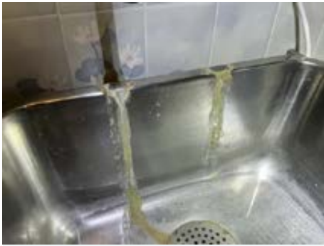
Korrosjon på vaske-kum.
