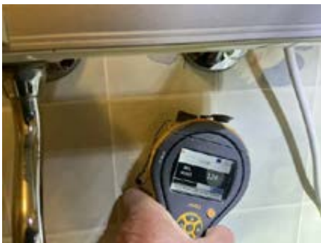
Ved fukt-søk undret blandedbatteri er det ikke registrert unormale verdier.
