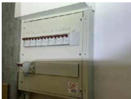
Sikringsskap står i bod.
